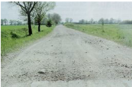
Bild 2: Wassergebundene Decke mit Schäden
